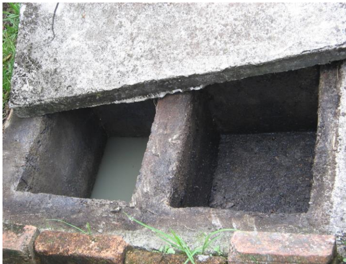
Foto 1. Tabique de sedimentación.
