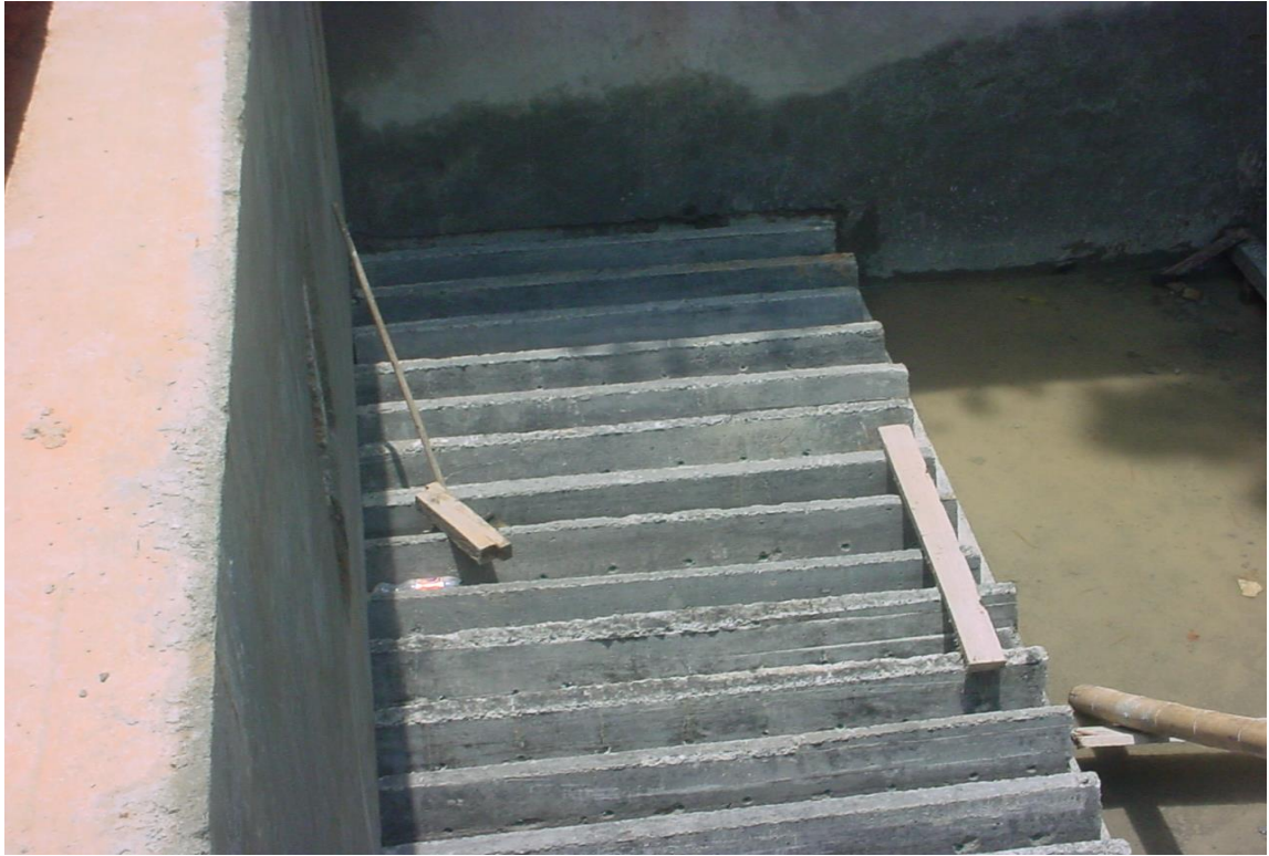
Fotografía 9. Detalle Fondo del Filtro
