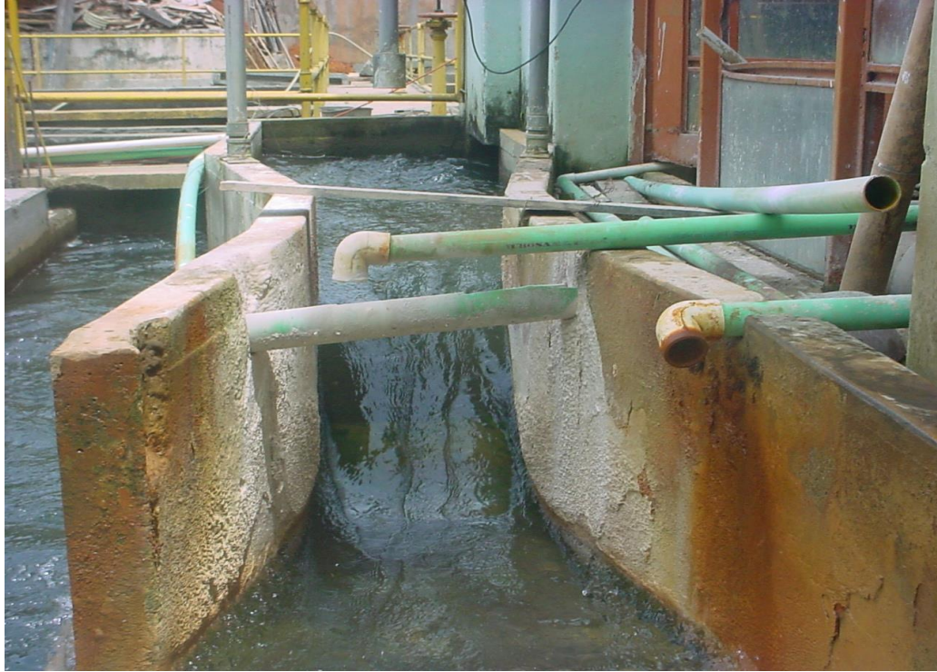
Fotografía 3. Detalle Canaleta Parshall
