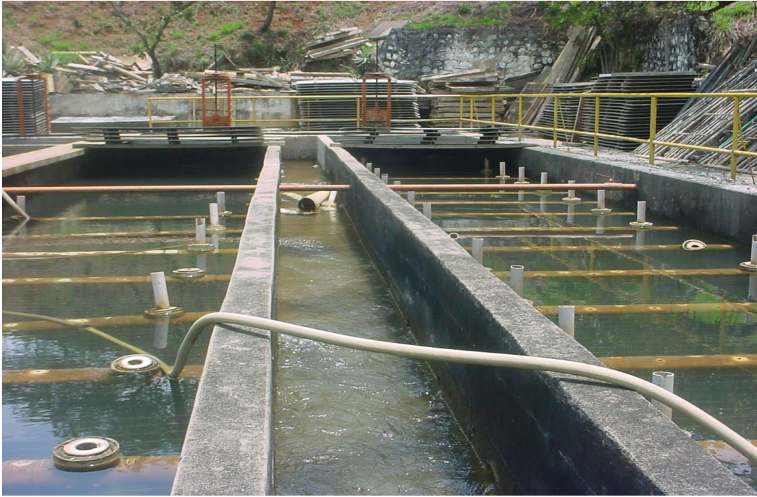
Fotografía 7. Detalle Canal de Agua Decantada
