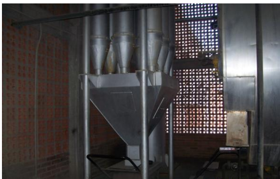
Figura 20. Control de emisiones atmosféricas ciclón caldera JCT
