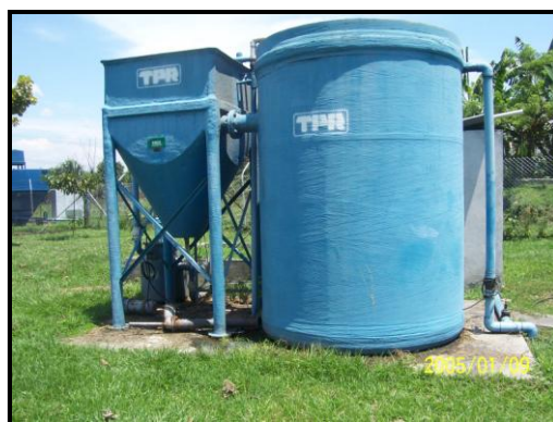
Figura 19. Planta de tratamiento A.R.D ICN
