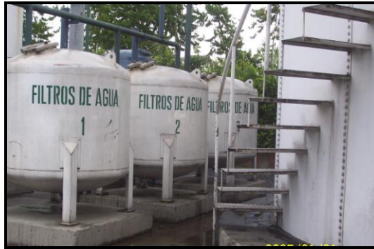
Figura 14. Tratamiento captación de agua pozo profundo ALPICAL S.A
