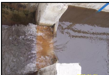
Figura 16. Efluente final de aguas residuales
