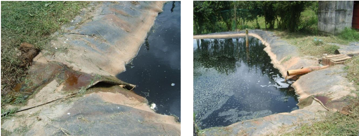
Figuras 17-18. Aportes laterales de caudal a la laguna de lixiviados
