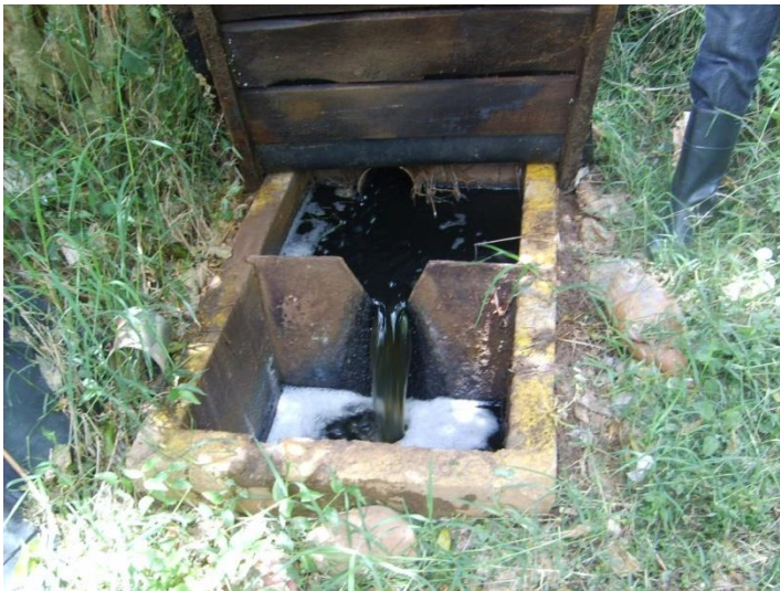
Figura 9. Toma de caudales en el efluente de la laguna
