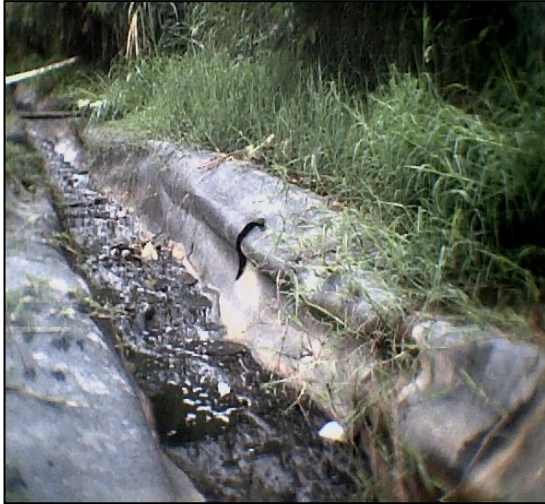
Figura 20. Lodos y sedimentos en el canal
