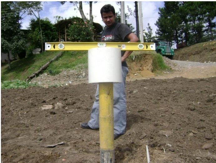
Figura 7. Instalación del tanque evaporímetro
