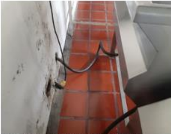
Figura 33. Instalaciones eléctricas en mal estado ubicadas dentro de la planta.
