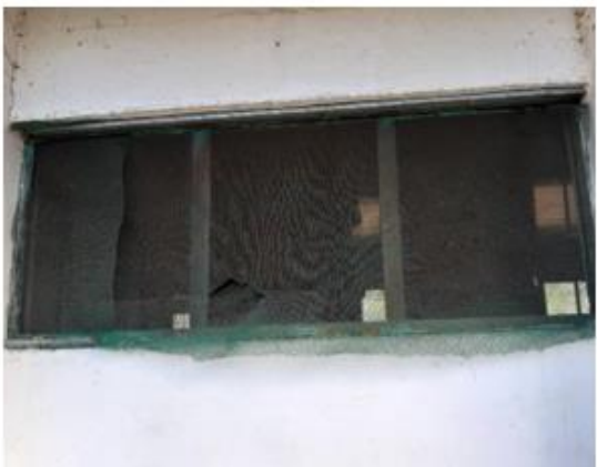
Figura 47. Malla de protección deteriorada
