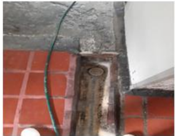
Figura 25. Canaleta de drenaje ubicada en el área de elaboración.
