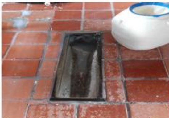
Figura 35. Piso y canaleta de drenaje del área de producción.
