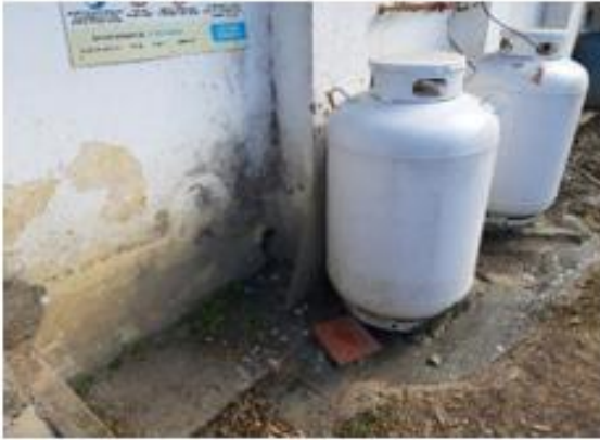
Figura 15. Pipas de suministro para la caldera de gas.
