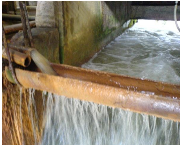
Figura 11. Punto de Aforo. Canal de entrada a la Planta de Tratamiento El Tablazo
