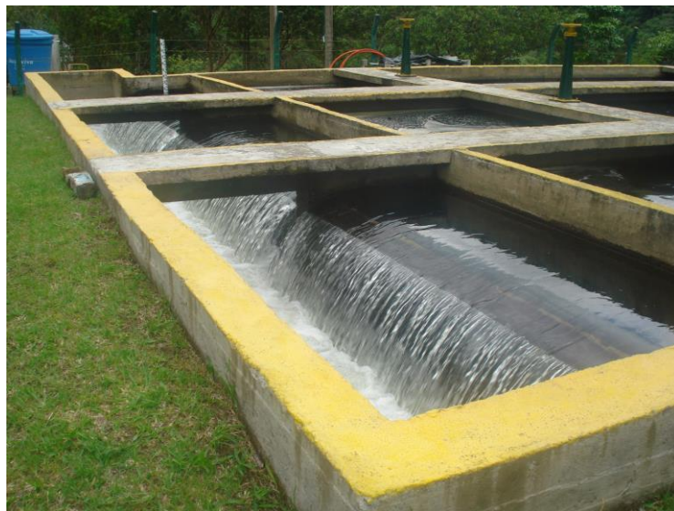
Figura 49. Tanques Desarenadores. Florida II.
