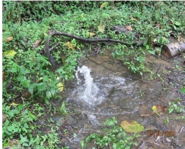
Figura 50. Daño en conducción.
