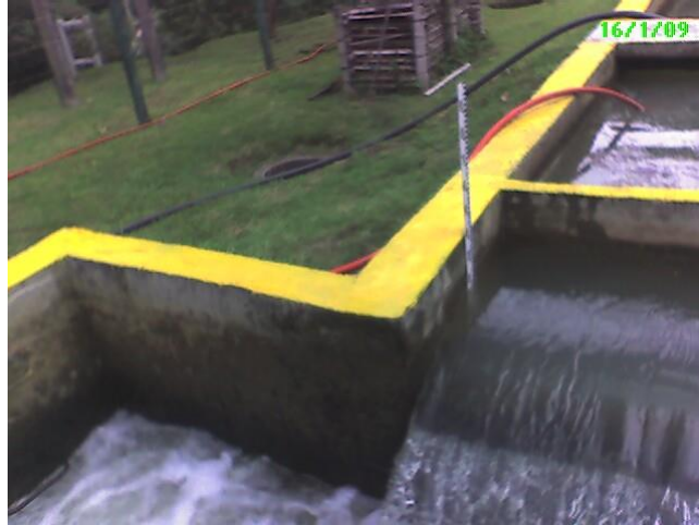
Figura 48. Vertedero en tanques desarenadores de Florida II. Entrada a la línea de conducción
