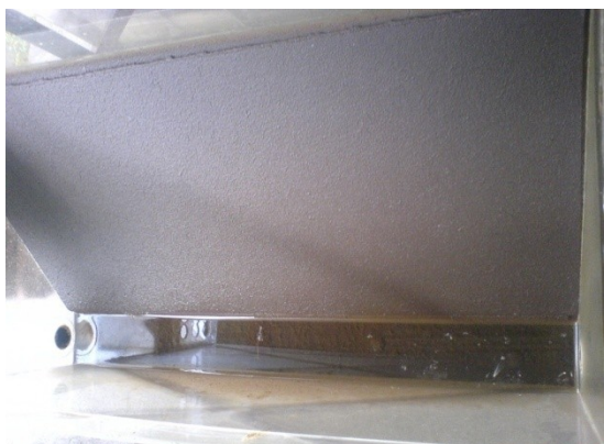
Foto 11. Lodo retenido en la pared de la tolva.
