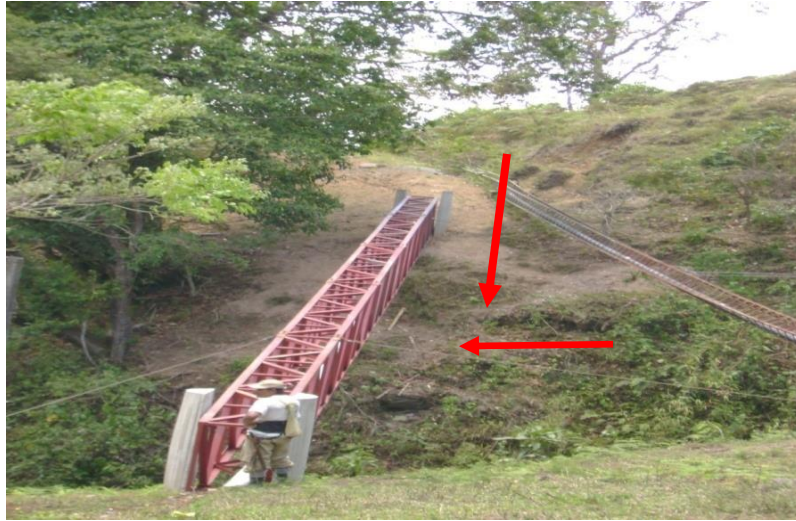
Figura 22. Formación de cárcavas, acueducto municipal de Rosas
