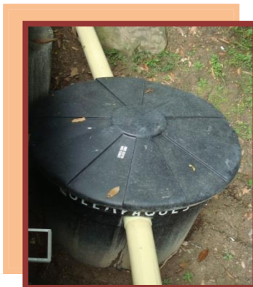
Tanque que contiene el efluente dosificado con cloro
