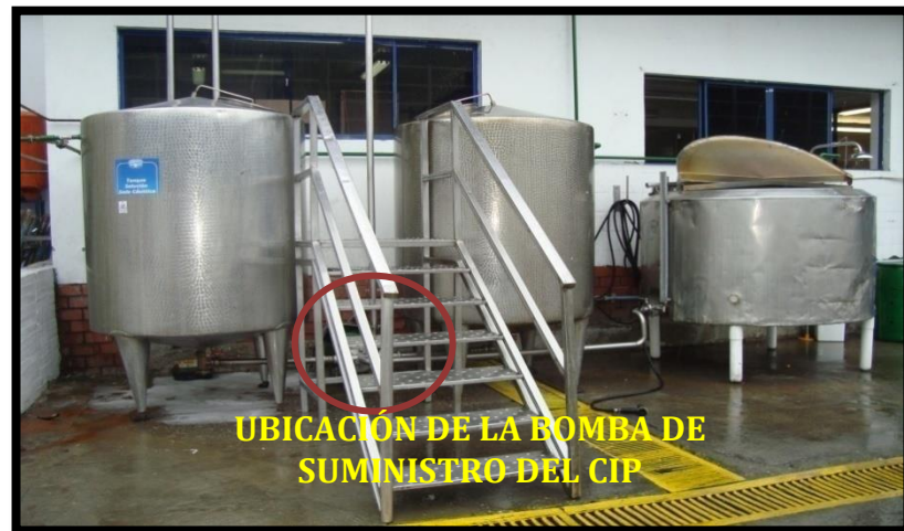
FOTO 4. BOMBA DE SUMINITRO DEL CIP
