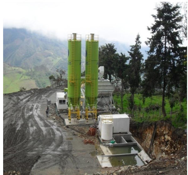
Sedimentadores en la planta de trituración Argos
