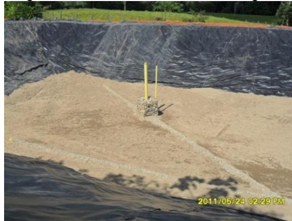
Figura 18. Sistema de evacuación de gases
