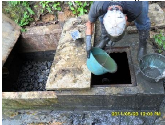
Figura 28. Mantenimiento del filtro para aguas lluvias
