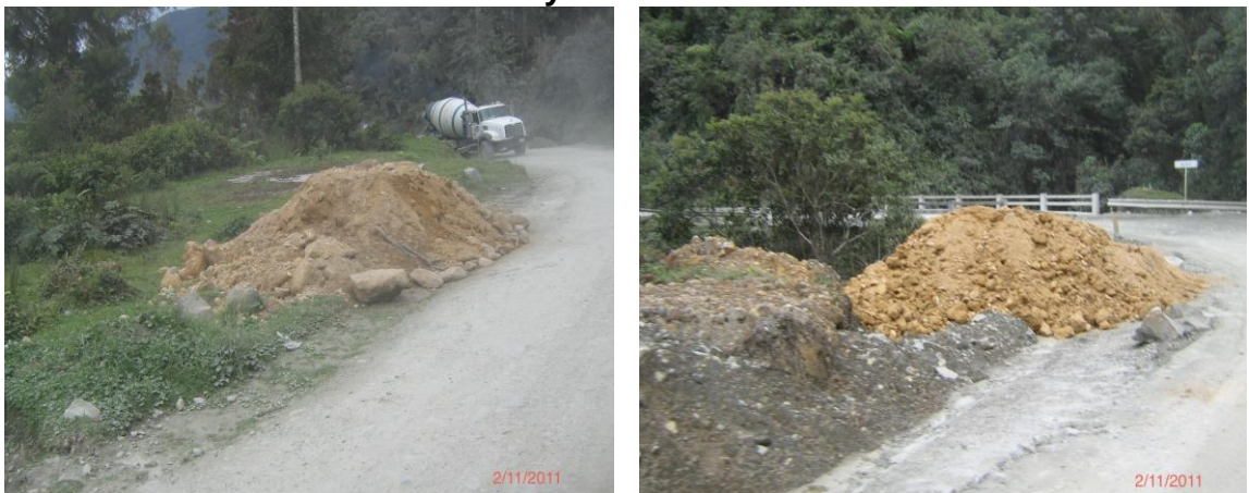
Figura 13. Material sobrante de corte arrojado en derechos de vía PR 62 + 000 y PR 62 + 100
