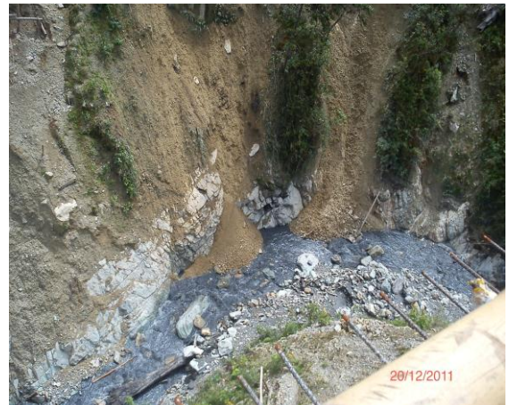
Figura 27. Caída de material sobre el río Guanacas
