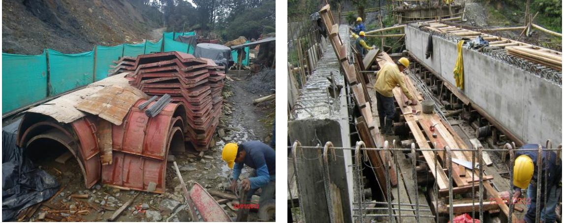
Figura 42. Se observa al personal de obra sin guantes realizando diferente labores
