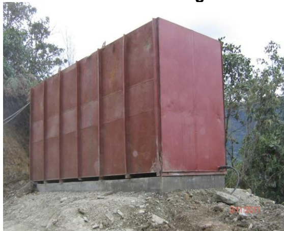
Figura 21. Tanque de almacenamiento de agua PR 74 + 590 para la planta
