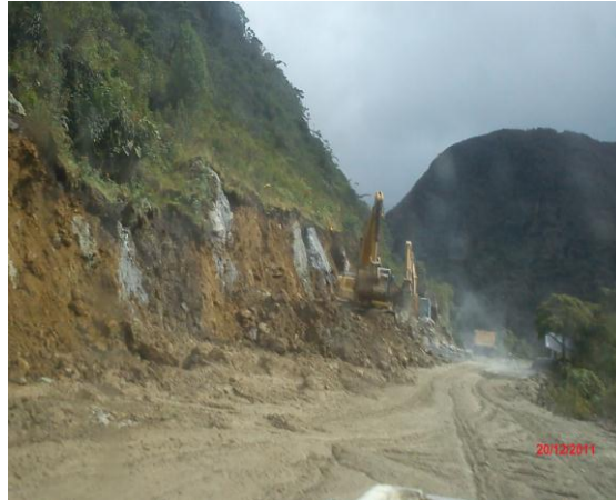
Figura 46. Falta señalización al realizar cortes en la vía
