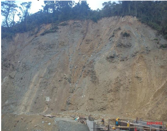
Figura 47. inestabilidad del talud en puente de Guanacas
