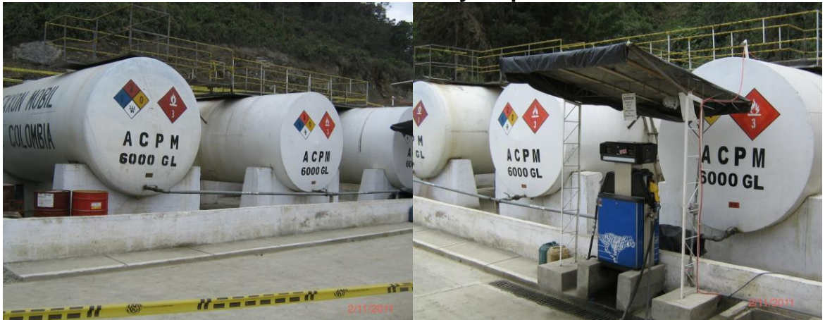
Figura 38. Depósito de combustible planta de trituración, en buenas condiciones de aseo y limpieza.
