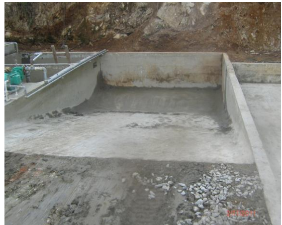
Figura 18. Sedimentador planta de Argos iniciando mes de Noviembre
