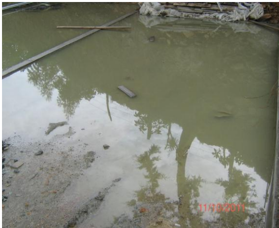
Figura 17. Sedimentador patio de Argos en malas condiciones de mantenimiento en el mes de Enero
