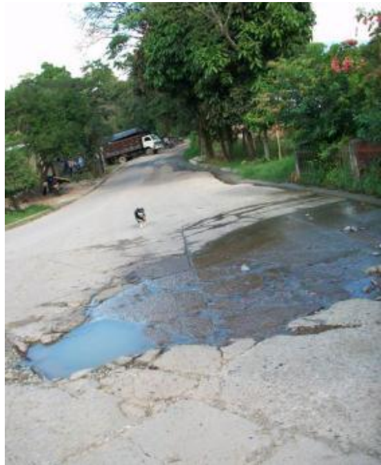
Figura 25. Alcantarilla sobre la vía que se encuentra rebosada permanentemente.
