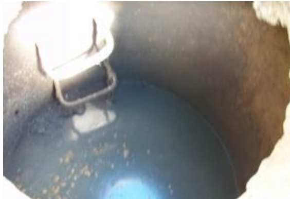
Figura 23. Alcantarilla que ha presentado rebosamientos.
