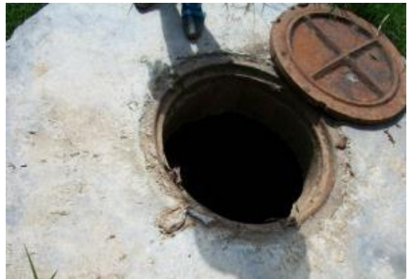
Figura 24. Alcantarilla que ha presentado rebosamientos.
