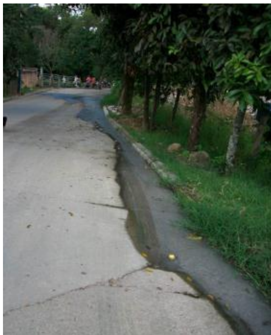
Figura 26. Las ARD provenientes de la alcantarilla fluyen por la vía principal del centro poblado.
