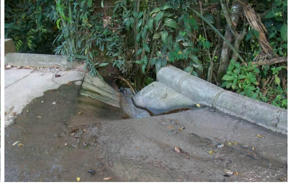
Figura 28. Canal por donde el ARD proveniente de las alcantarillas rebosadas fluye hacia la quebrada Los Bollos.
