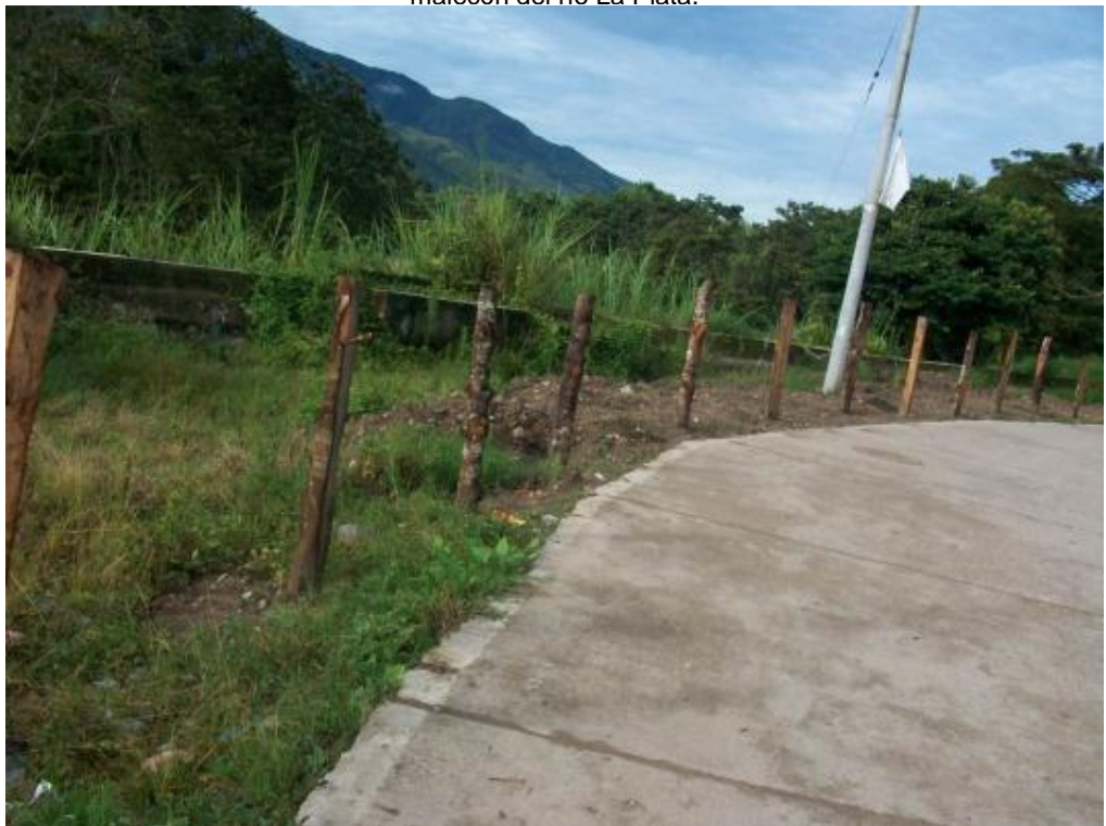
Figura 22. Material forestal donado utilizado en el aislamiento del sitio donde se ubicará el malecón del río La Plata.
