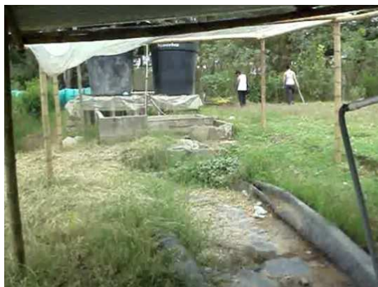
Figura 4. Zona del biodigestor
