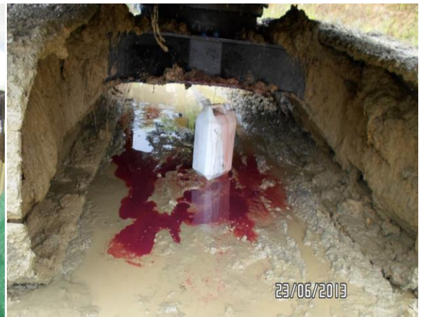
Figura 29. Derrame accidental de aceite en obra.
