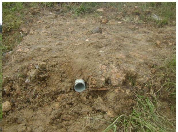
Figura 31. Tubería de salida de gases.
