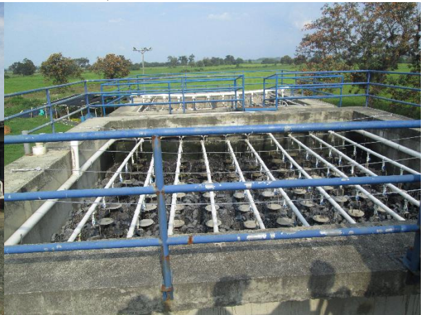
Figura 19. Filtros percoladores PTAR Terranova, Jamundí.
