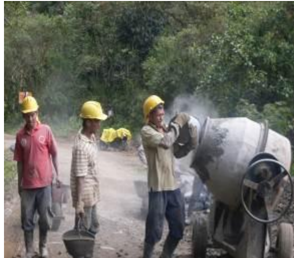
Figura 8. Inadecuado manejo de implementos de seguridad industrial.
