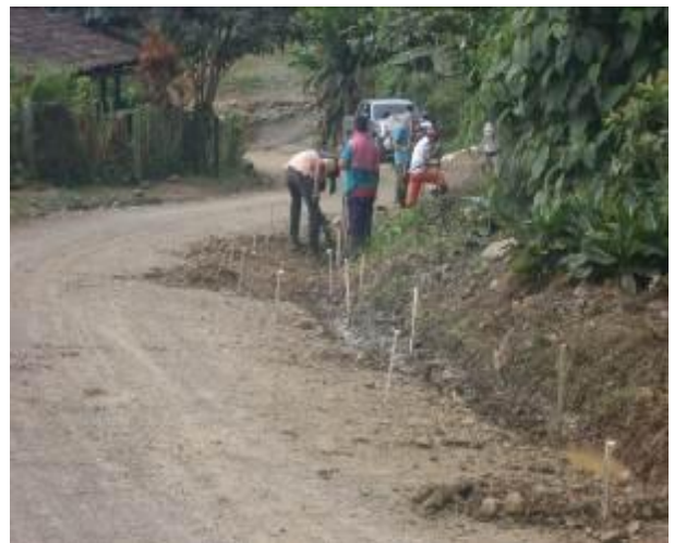
Figura 22. No se cuenta con señalización en el frente de obra.
