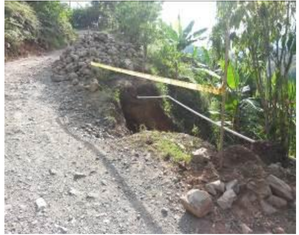
Figura 17. Falta señalización en el frente de obra.
