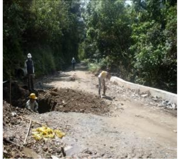
Figura 2. Falta de señalización en la vía.
