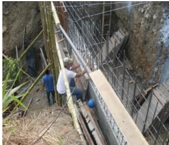
Figura 25. No se cuenta con adecuado manejo de implementos de seguridad industrial.
