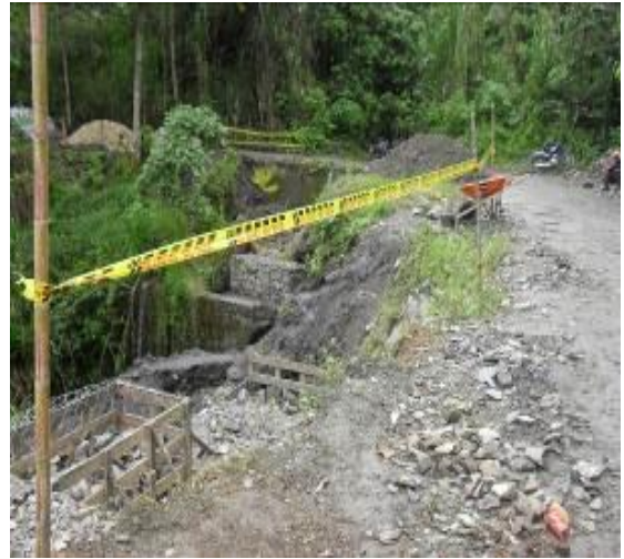
Figura 10. No se tiene la suficiente señalización del frente de obra.
