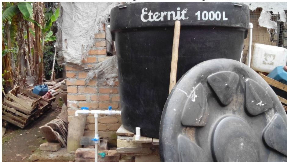
Figura 28. Tanque de almacenamiento de agua. Vereda El Hogar
