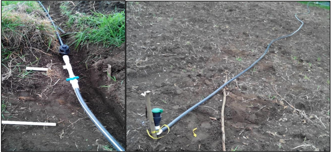
Figura 23. Materiales utilizados en los sistemas de riego. Vereda Santa Elena
