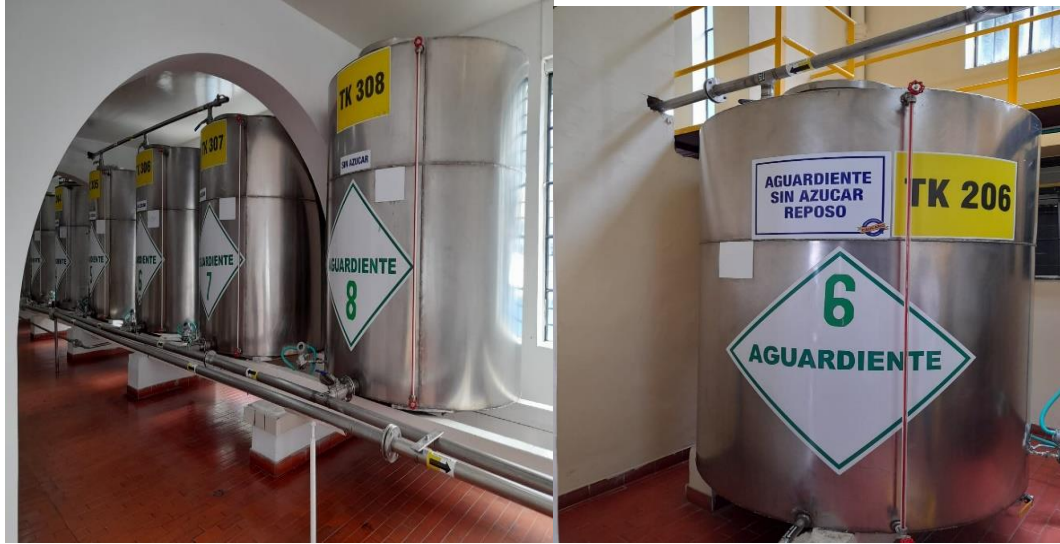
Figura 5. Almacenamiento para estabilización del aguardiente
