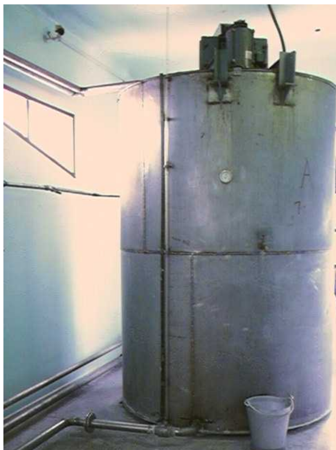
Figura 24. Tanque de Preparación.
