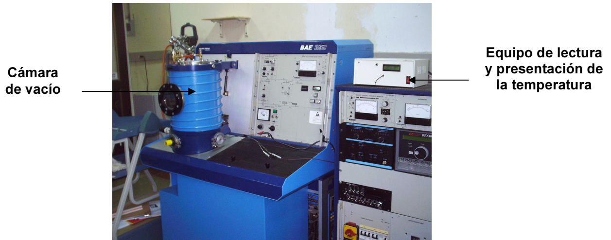
Figura 16. Equipo de lectura y presentación de la temperatura del horno instalado.
