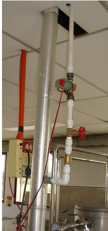
Figura 8.2. Electroválvula y tubería instaladas.
