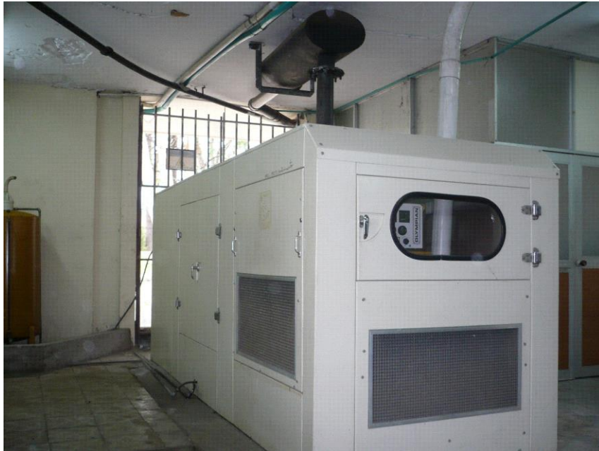
Figura 3.1.3 Planta Caterpillar de 175 KVA (Sistema alterno de energía eléctrica en el HSLV).
