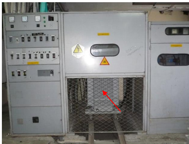
Figura 3.1.2 Transformador de 315 KVA presente en la subestación del HSLV.
