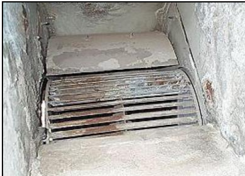
Figura 4.1. Fotografía de las incrustaciones que se forman en el de un condensador evaporativo.
