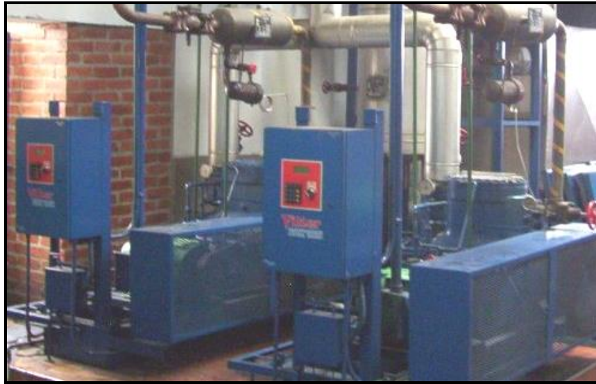
Figura 2.12. Fotografía de los compresores Vilter modelo 452XL de 30 hp que operan en el sistema de refrigeración auxiliar.
