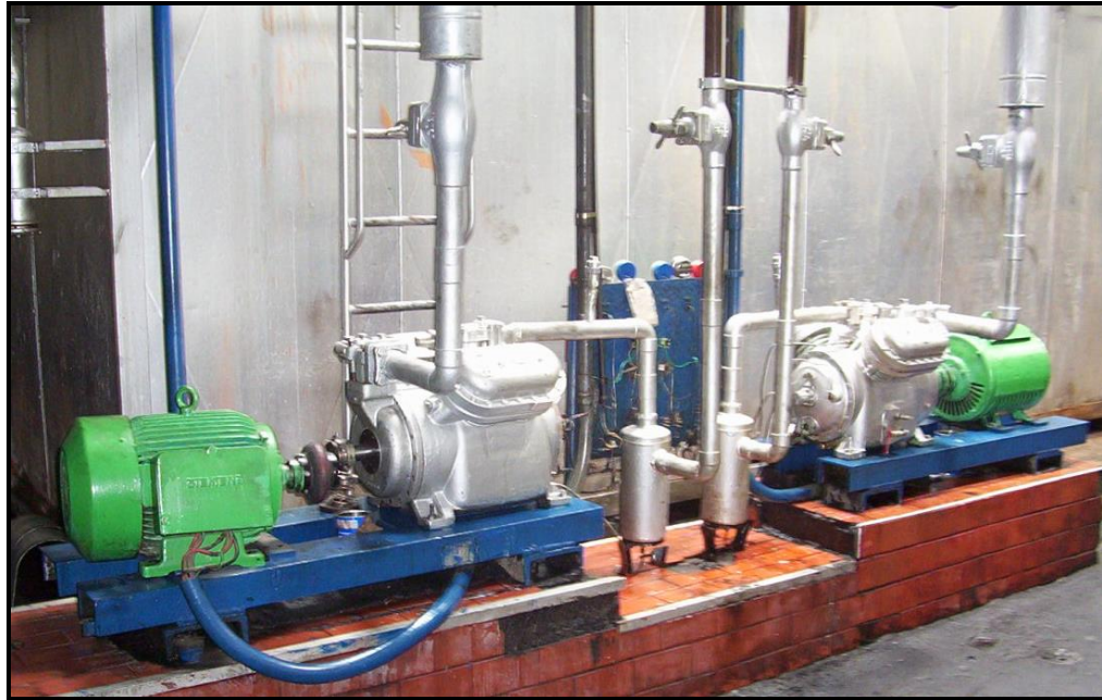
Figura 2.8. Fotografía de los compresores Dunham-Bush modelo E-208 DCN de 25 hp que operan en el sistema de refrigeración secundario.
