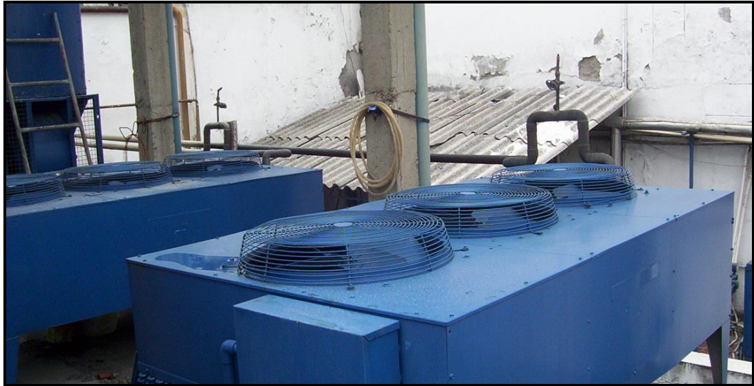
Figura 2.9. Fotografía de los condensadores del sistema de refrigeración secundario.
