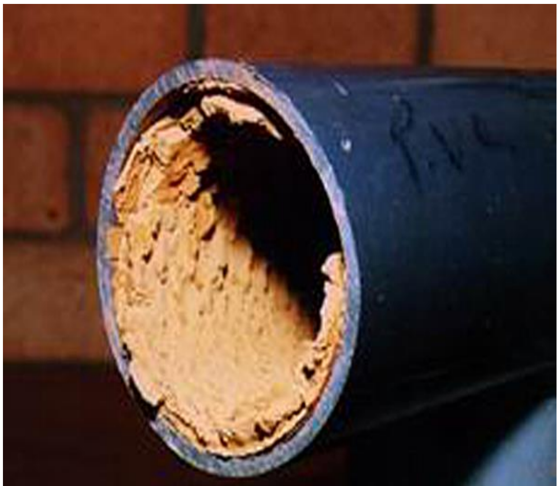
Figura 2. Acción de las sales de calcio y magnesio en la tubería.
