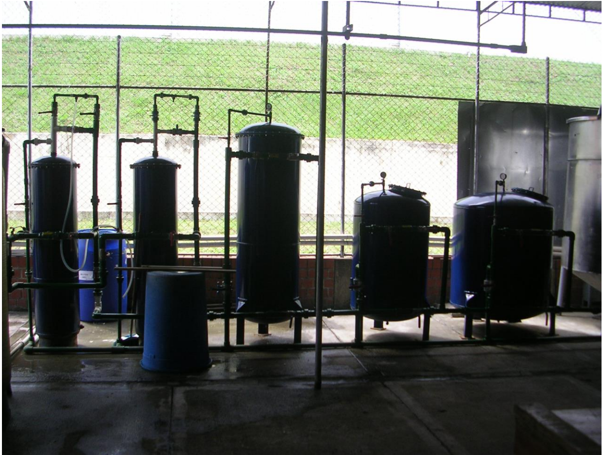
Figura 1c. Sistema de purificación física de agua de la empresa VINCORTE.
