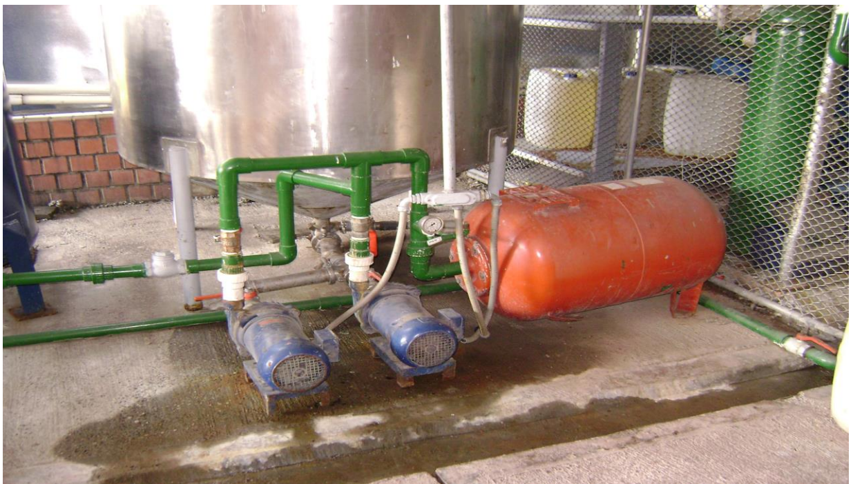
Figura 1b. Sistema de suministro de agua de la empresa VINCORTE.
