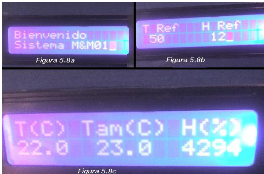
Figura 5.8 Despliegue del sistema de control en la LCD; 5.8a pantalla de inicio del sistema; 5.8b pantalla para referenciar la temperatura y humedad; 5.8c pantalla de monitoreo mientras se ejecuta control
