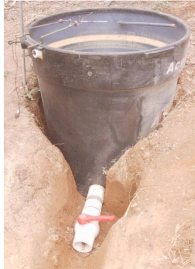
Figura 8. Tanque de 500 L y válvula de bola de 3", instalado al inicio del canal, desde donde se suministrará el fluido.
