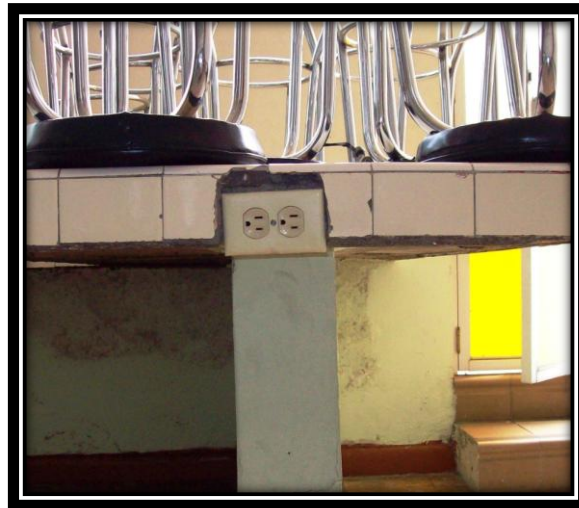
Figura 3.11. Tomacorriente en mesa de trabajo
