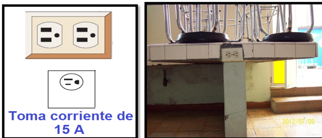
Figura 5.4. Señalización de los toma corrientes
