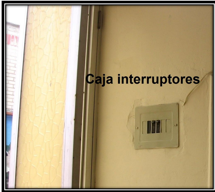
Figura 3.10. Caja de interruptores
