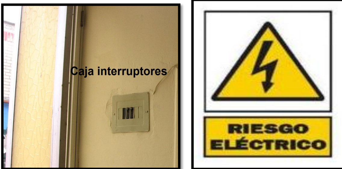
Figura 5.6. Señalización de la caja de interruptores
