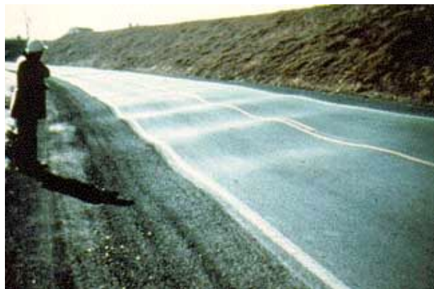
Figura 4. Ahuellamiento de una mezcla asfáltica en servicio.
