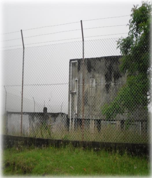
Anexo 61. Tanques de almacenamiento
