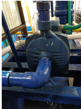
Figura 4.3: Purga motobomba Fuente: Elaboración propia
