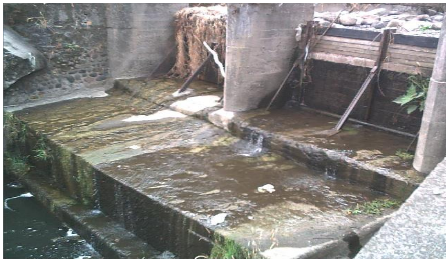
Figura 23. Estación 4, presa río Grande
