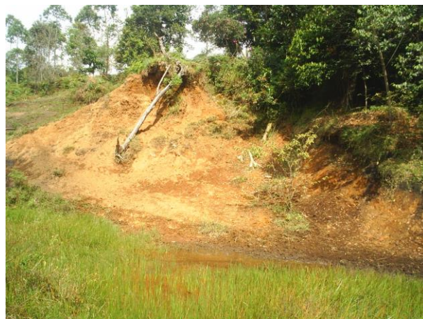
Erosión en la ronda del humedal
