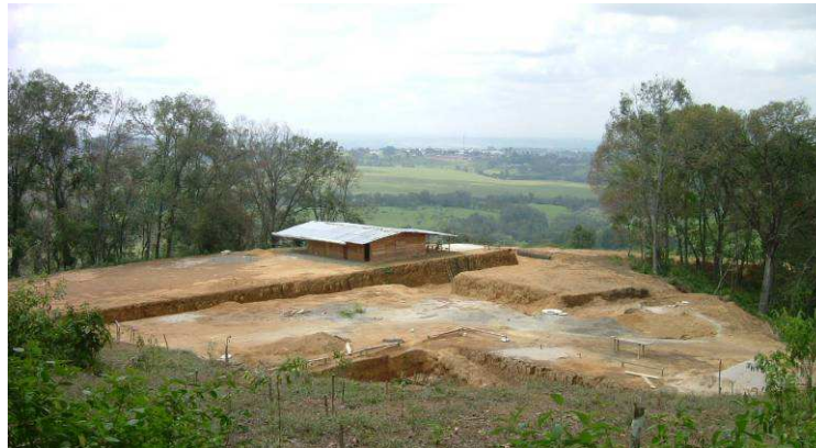
Figura 20. Limpieza y adecuación del terreno para el establecimiento de la planta de tratamiento, nuevo acueducto de la ciudad de Popayán.
