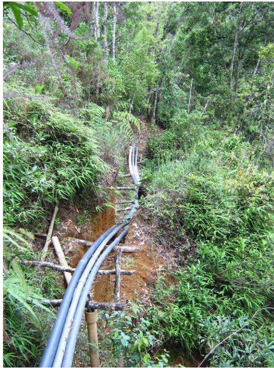
Figura 28. Tubos de conducción de agua que atraviesan el relicto, acueducto veredal Clarete.
