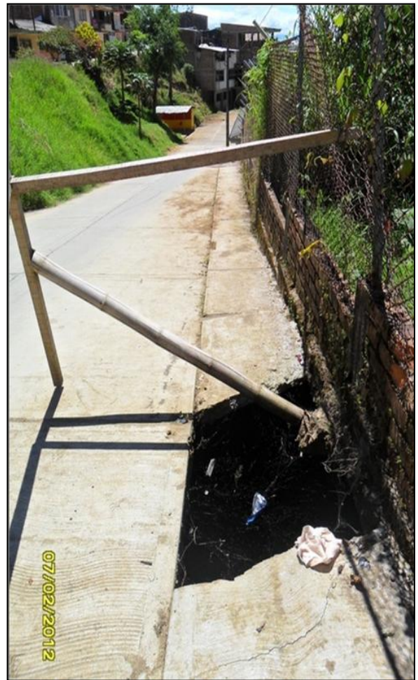
Figura 14. Estado de las vías públicas de Balboa, por daños del alcantarillado.
