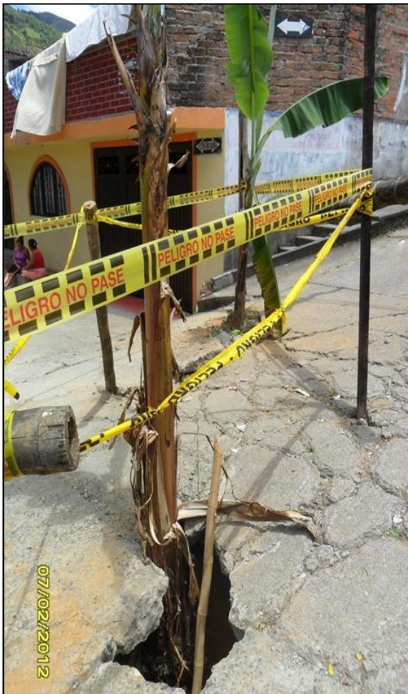
Figura 13. Estado de las vías públicas de Balboa, por daños del alcantarillado.
