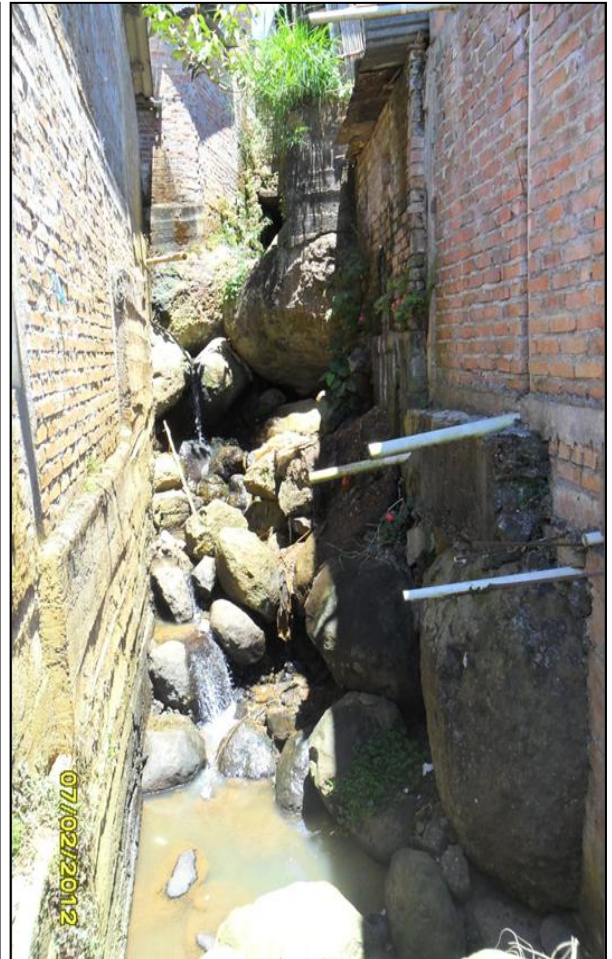
Figura 10. Vista del estado de la quebrada.
