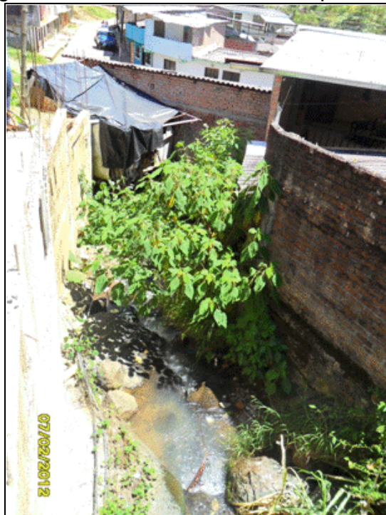
Fuente. Punto en el barrio Belén, donde se observan construcciones al borde y encima de la quebrada y cañerías de aguas servidas residenciales.
