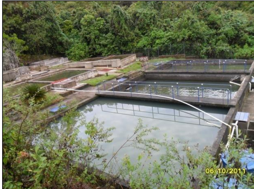
Figura 16. Tanques de recolección del Acueducto de Balboa.
