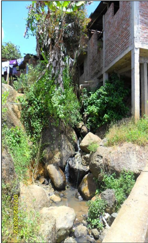
Figura 9. Vista del estado de la quebrada.
