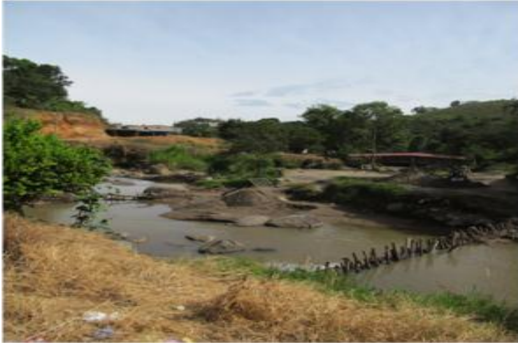
Foto: Trinchos en el cauce del río Molino para la explotación de material aluvial.
