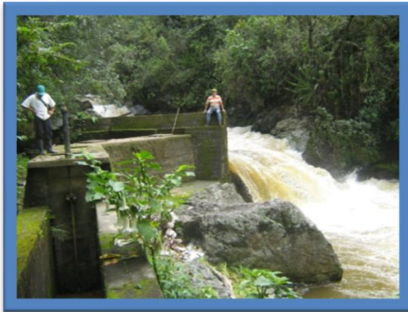
Figura 1. Bocatoma ubicada en la Vereda la Estrella la cual abastece el Acueducto regional Piendamó – Morales. Autora: Marcela Jojoa.
