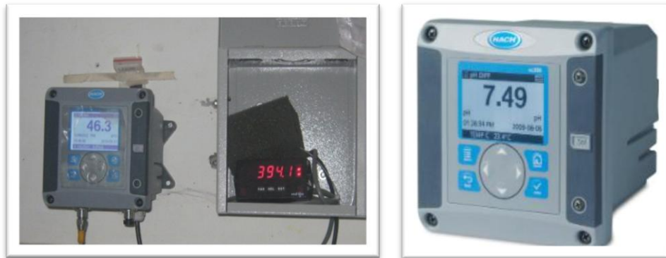
Figura 13. (Controlador universal Hach sc200™)
