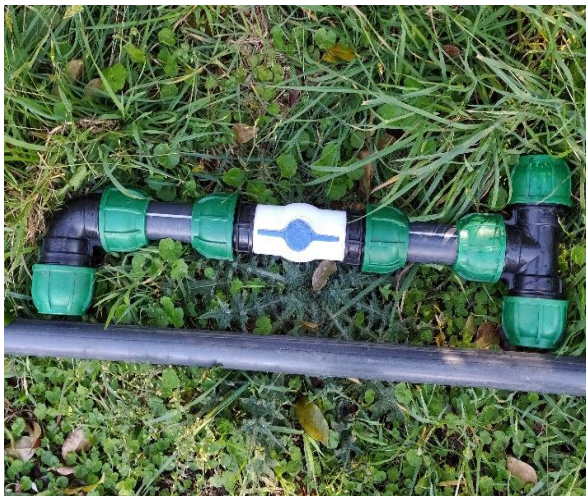
Figura 69. Circuitos de riego, detalle la válvula de control, uniones rápidas
