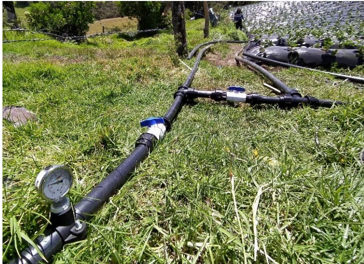
Figura 68. Cabezal de bloques de riego, detalle manómetro y válvula de control.
