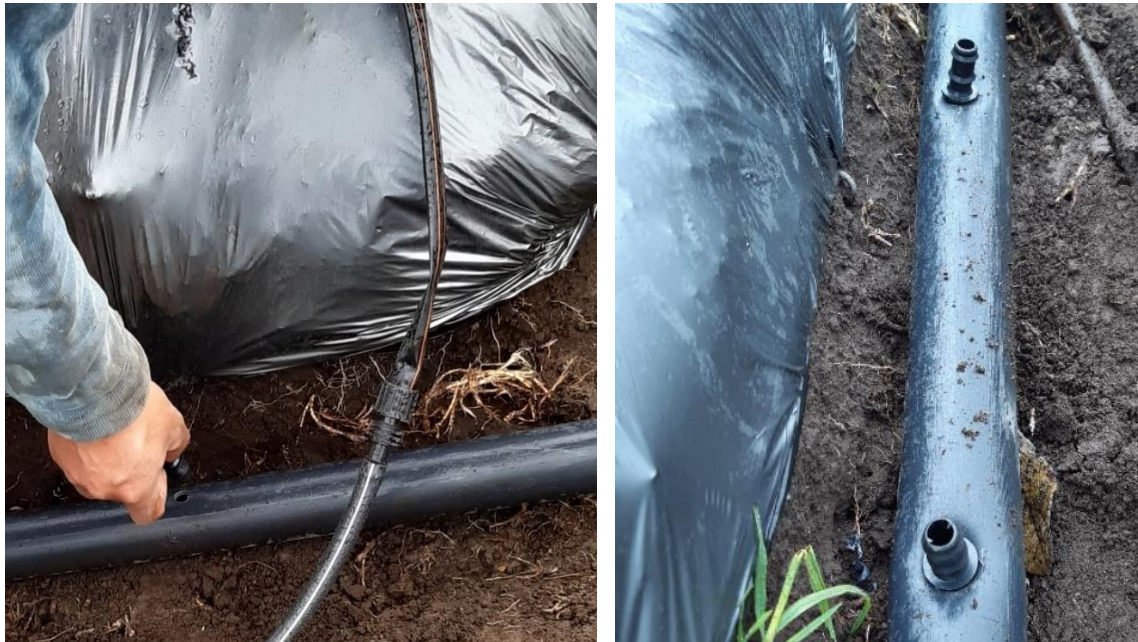
Figura 71. Uniones cinta manguera y arrancadores 16 mm.
