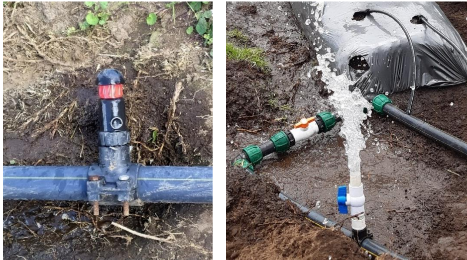
Figura 73. Ventosas y válvulas de control (ventosa manual).
