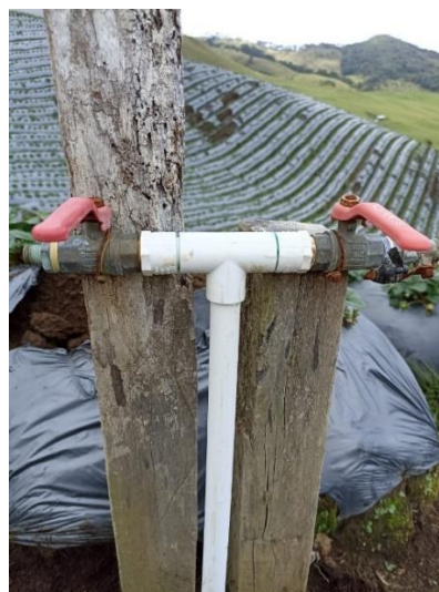
Figura 81. Punto de conexión a mangueras, en forma de T.
