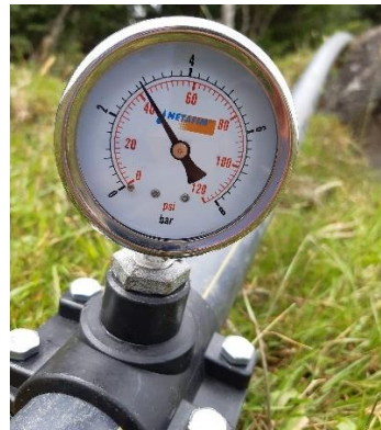
Figura 66. Manómetro en cabecera de bloque, marcando presión de 42PSI.
