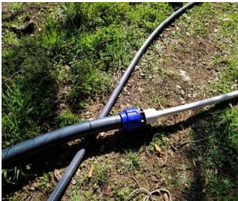
Figura 65. Reducción en tubería de 3" a 1 ½"
