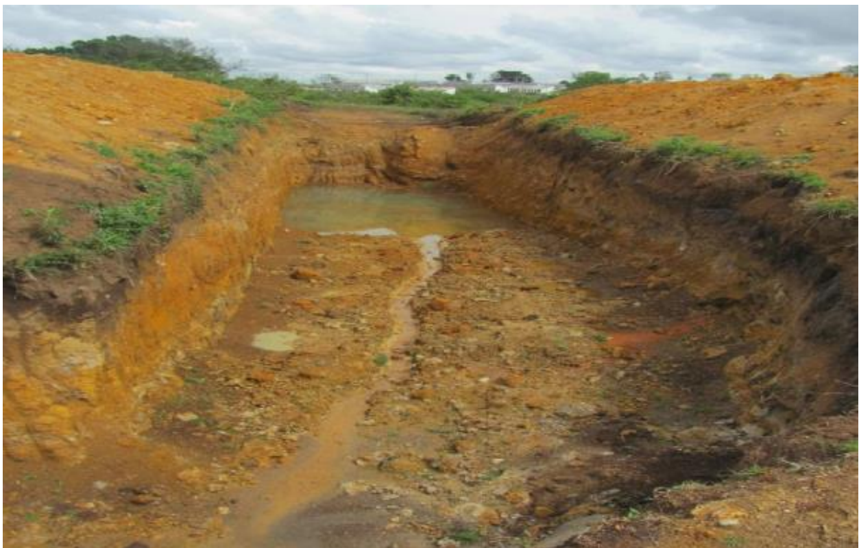
Fotografía 12. Zanjas abiertas con maquinaria afectando humedal 1 y 2. II Fase obra
