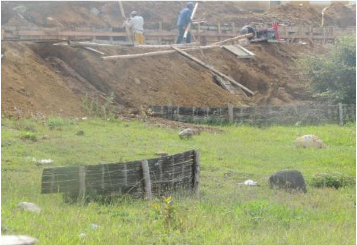
Fotografía 25. Obras en desarrollo y trinchos para detener la sedimentación obsoletos para este tensor
