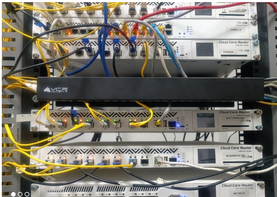
Figura 3.4 Equipos Oficina Central Dobleclick
