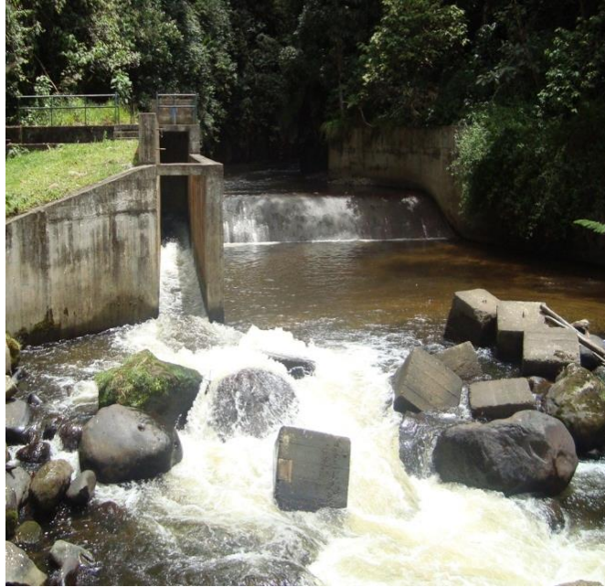
Fuente. Acueducto y alcantarillado de Popayán, 2012
