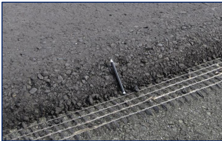
Figura 2-2. Detalle de Mezcla densa en caliente instalada como capa de refuerzo de una pista de aeropuerto.
