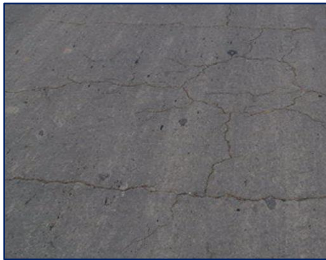
Figura 2-6. Agrietamiento térmico en estructuras de pavimento flexible.
