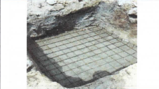
Suministro de Acero de refuerzo Fy = 60,000 lnc. corte, figurado y amarr. Para Zapatas
