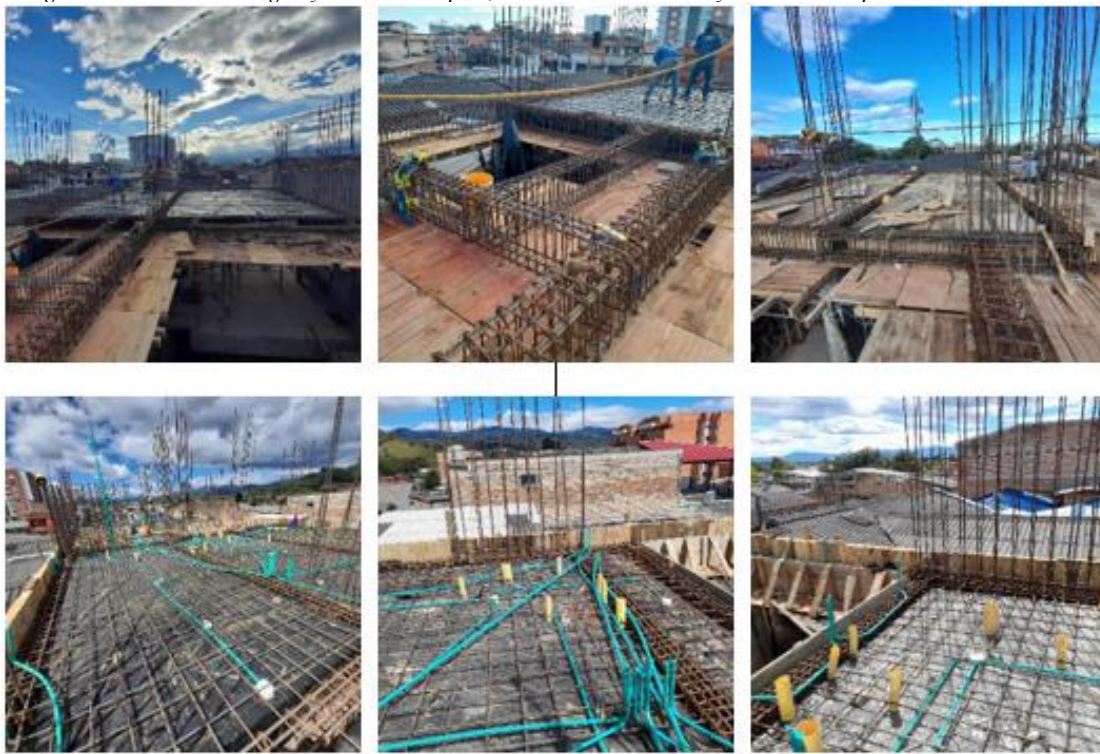
Figura 38.- Armado de vigas y losa de entrepiso, acometidas eléctricas y ubicación de puntos hidrosanitarios.
