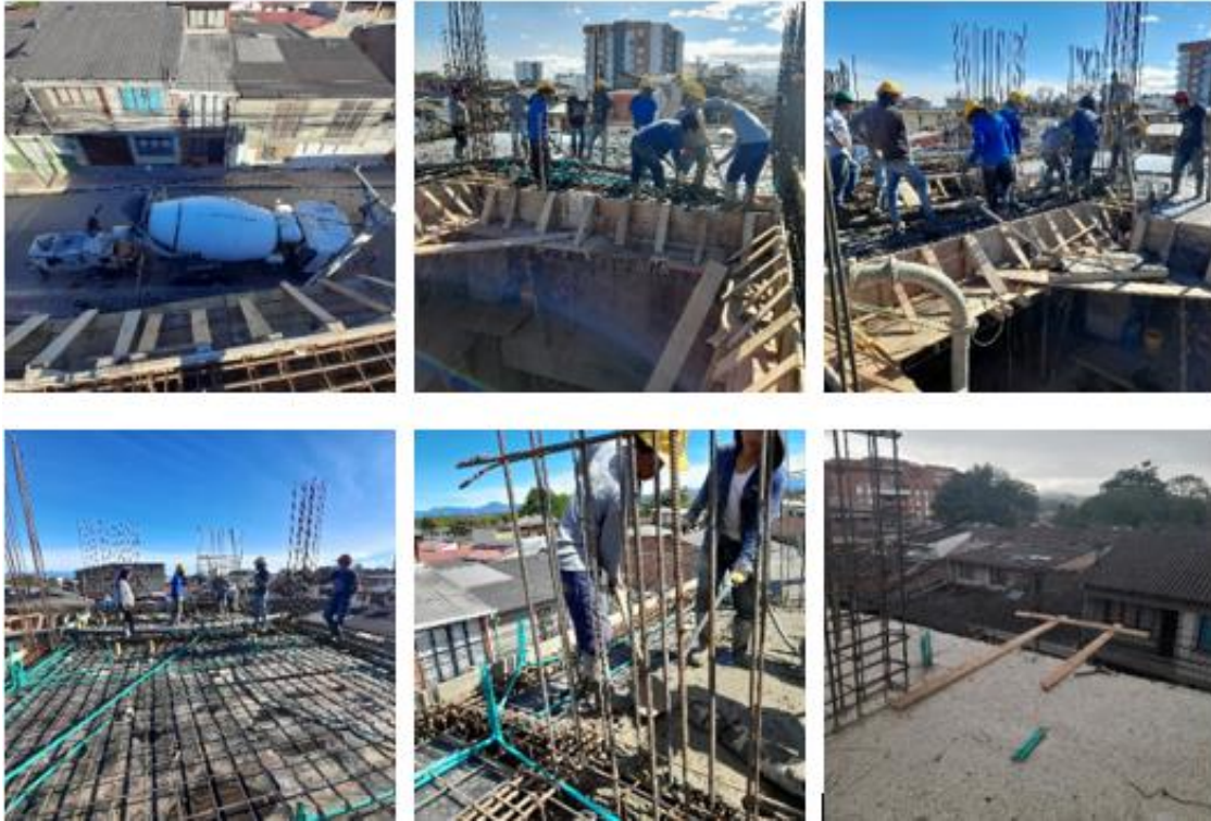
Figura 39.- Vaciado de la losa de entrepiso, replanteo de los ejes par los nuevos elementos verticales.
