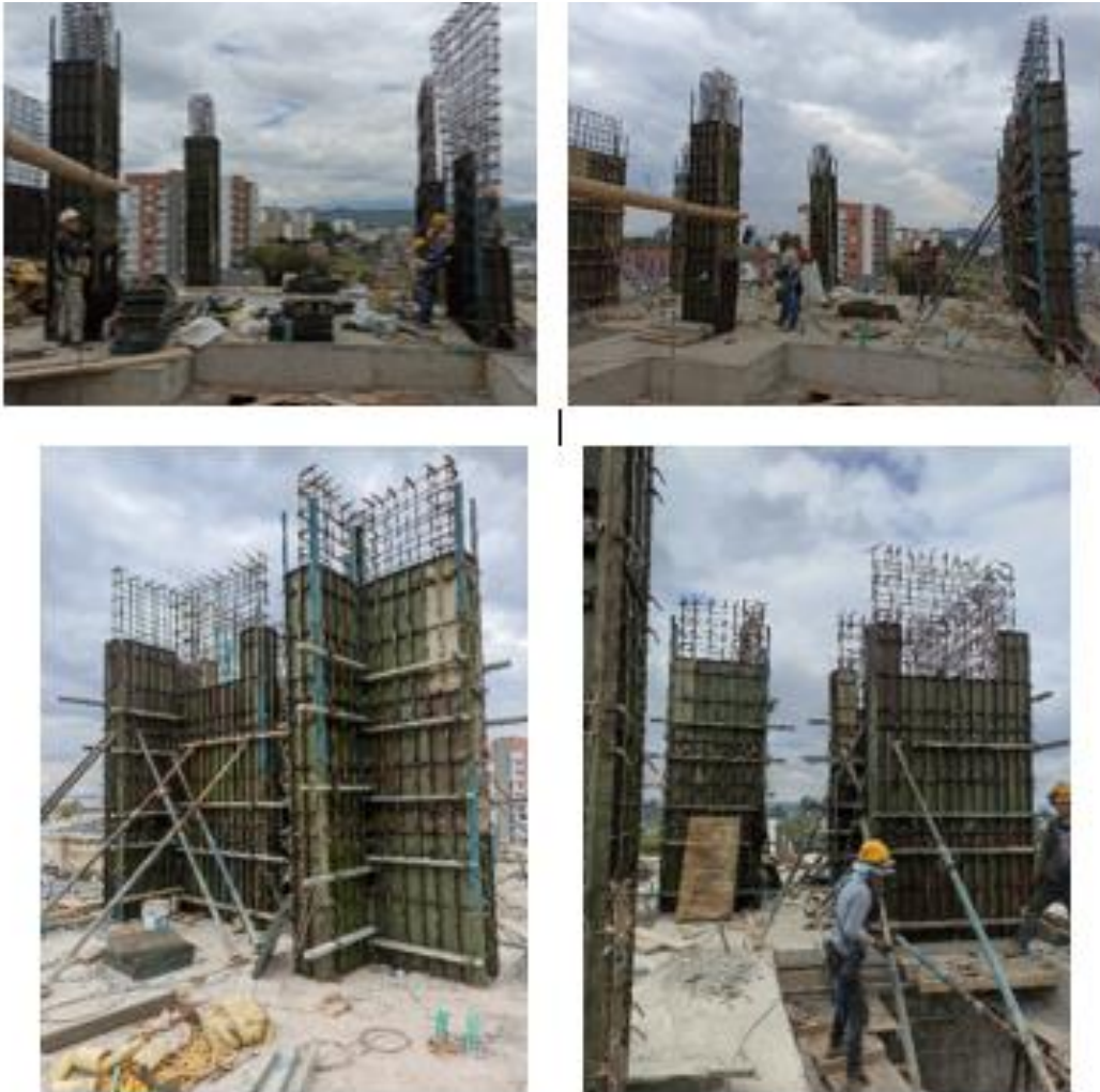
Figura 54- Encofrado de los elementos verticales que inician en el nivel N+13,86 hasta el nivel N+18,36.
