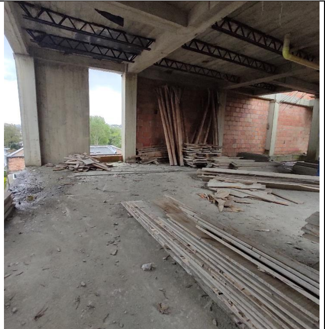
Losa del sexto nivel sin licenciar.
