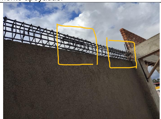
Doble traslape de acero longitudinal con estribos menos distanciados entreis en cerca de los nudos.
