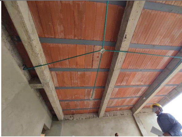
Viguetas en gran luz sin soporte adecuado.
