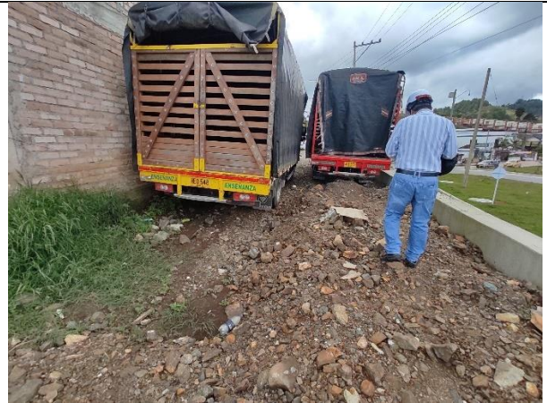
Relleno en roca muerta en el predio infractor para compensar el peso del material retirado.
