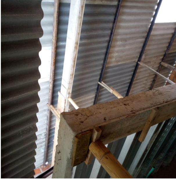
Techo en estructura metálica con perfiles en C y teja de Eternit con grandes luces.
