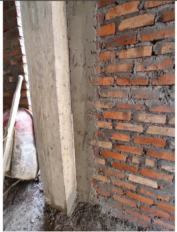
Muros confinados y correctamente separados del sistema porticado con lamina de icopor.
