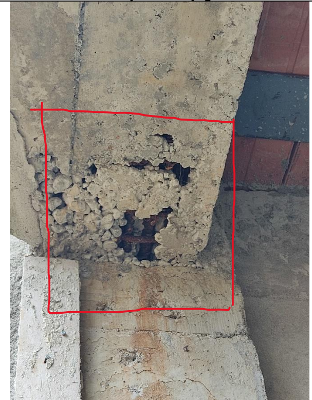
Secciones estructurales con mal proceso de vibrado.
