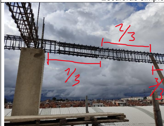
Traslapes muy cerca de las intersecciones columna vigueta, aceros menos distanciados entre si en los traslapes.
