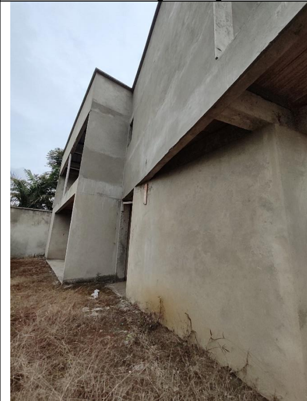
Los muros estructurales no mantienen continuidad.
