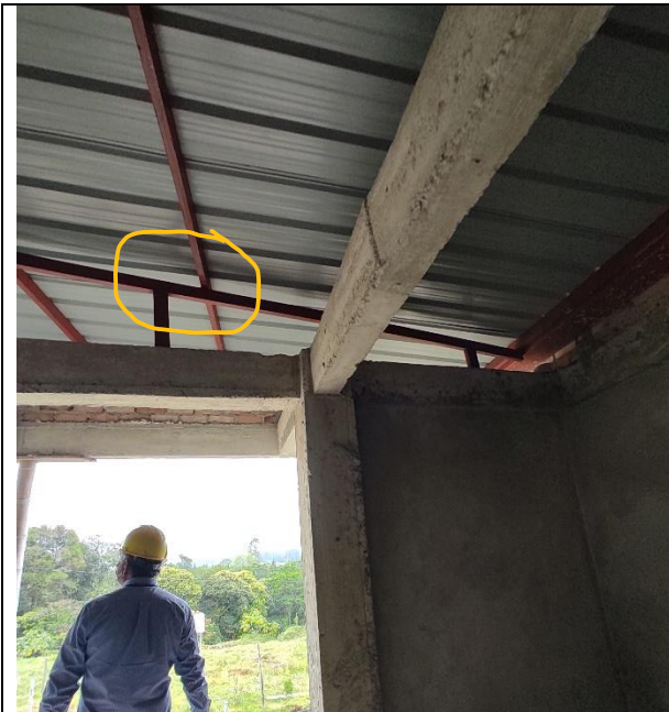
Cubierta en estructura metalica sin diseño estructural apropiado.
