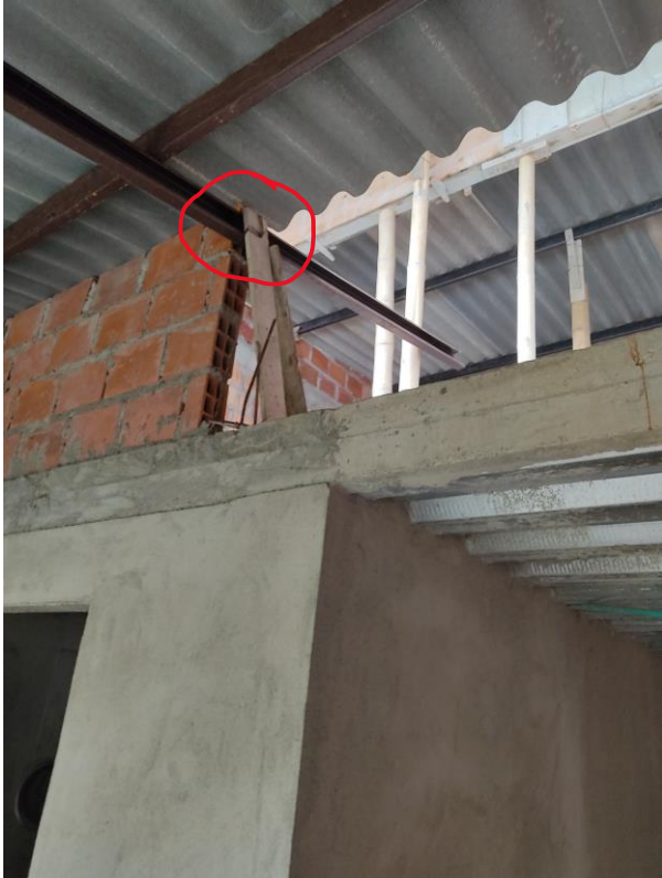
Perfil metálico que es parte del techo que cubre el segundo nivel sin buen soporte.
