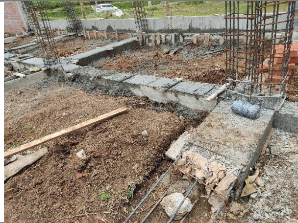
Armado incompleto y fundicion no monolitica de las vigas de cimentacion.
