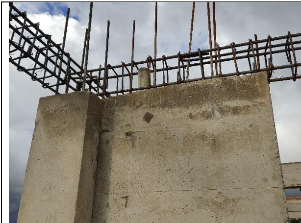
Pantalla estructural, estribos de viguetas separados equidistantes.
