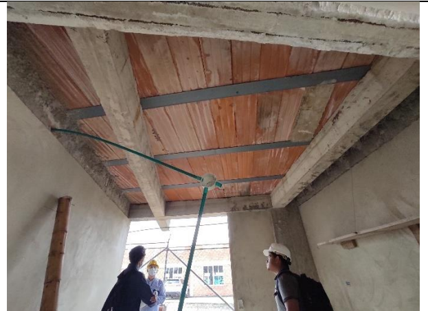
Vigas que sostienen losa sin soporte confiable y luz muy grande.
