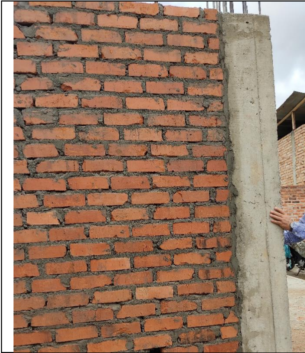
Muros sin dilatacion.
