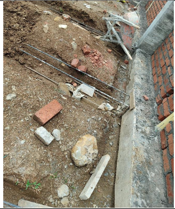
Vigas de cimentacion de las casas colindantes sin armado completo.
