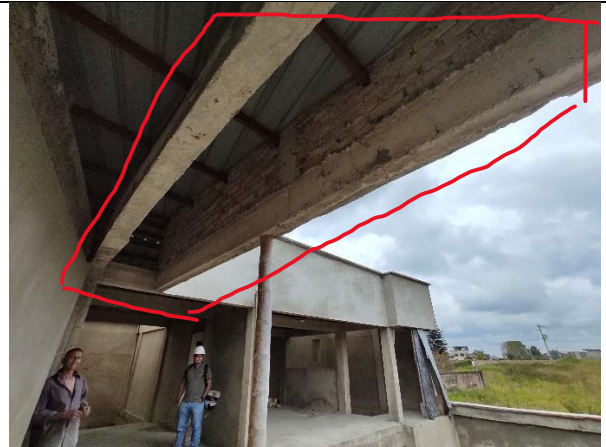
No se evidencia soporte adecuado para culatas que sostienen cubierta.
