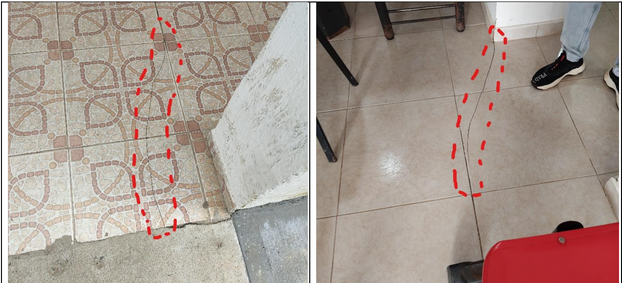
Baldosas del enchape sobre el piso primario afectadas por la descompensacion.
