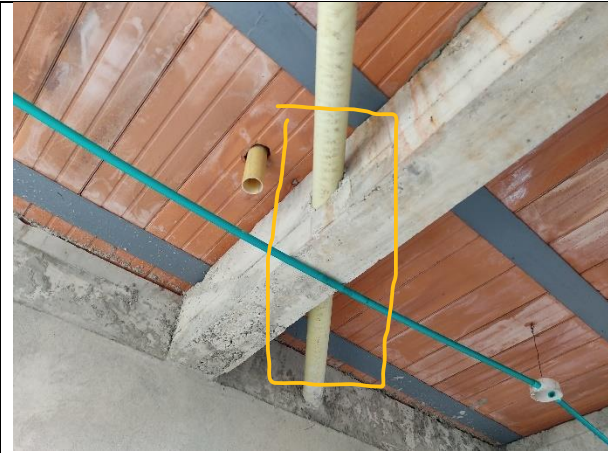
Seccion estructural untervenida con tuberia de aguas negras.
