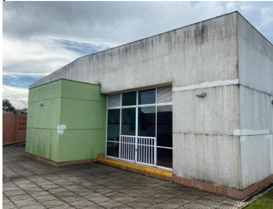
Imagen 36. Humedad y desprendimiento del revestimiento plástico.
