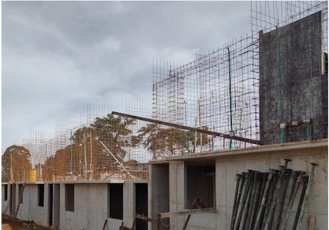
Vista de la instalación de mallas casas de la 8 a la 11 manzana 1.
