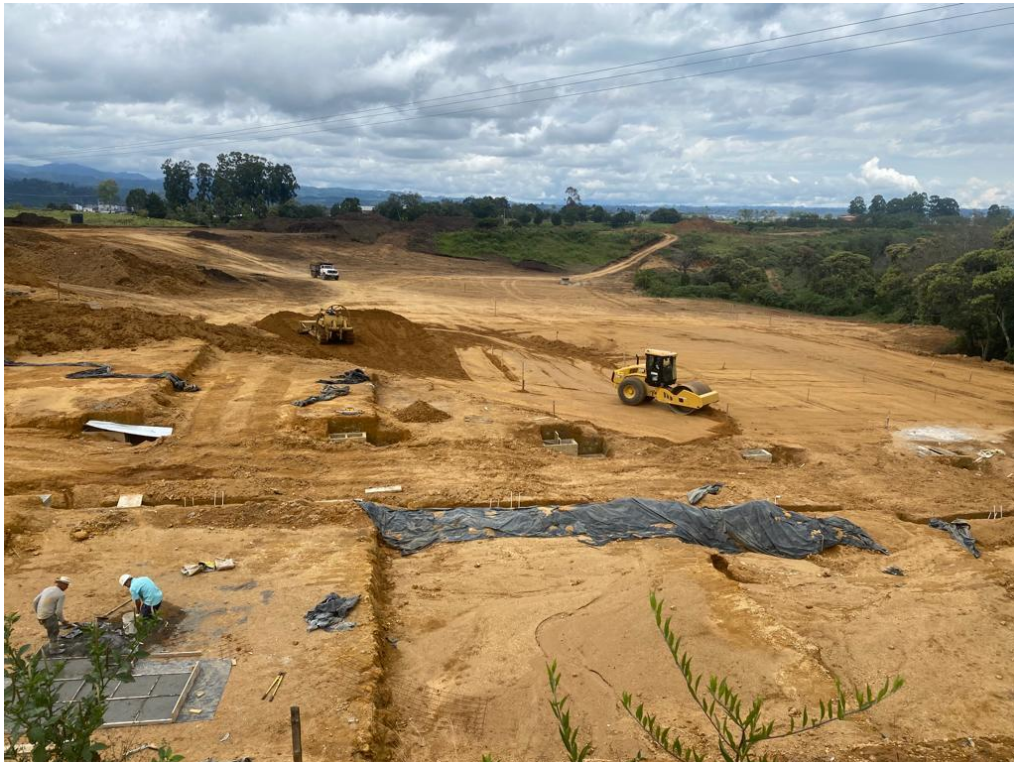
Vista desde la zona de campamentos hacia las manzanas 1 y 2. Fuente: Constructora Gracol SAS.
