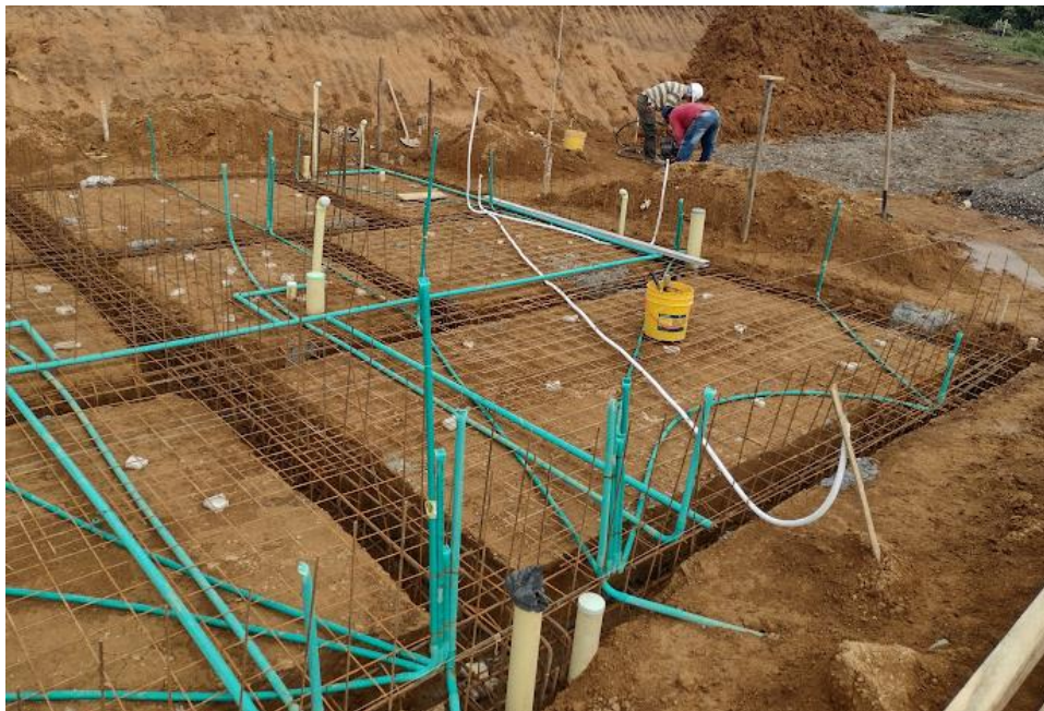
Vista de las instalaciones de Gas y eléctricas manzana 1 Casas 1-1 a .
