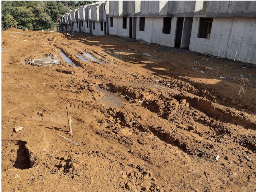
Vía interna 1 en estado saturado de agua.
