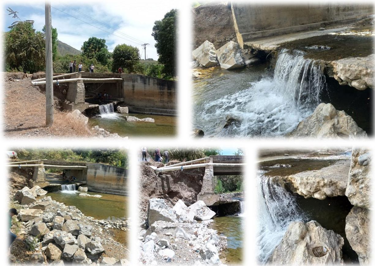
Ilustración 36: Evidencia Puente Sachamates
