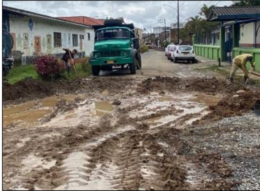
Imagen 70. Fuente propia: Generación de barro y fallas
