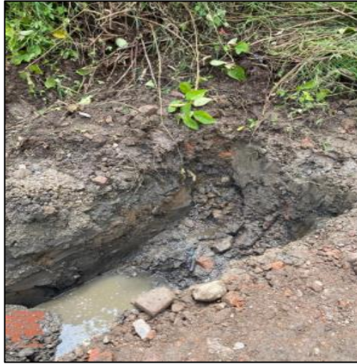
Imagen 60. Fuente propia: Filtración de agua
