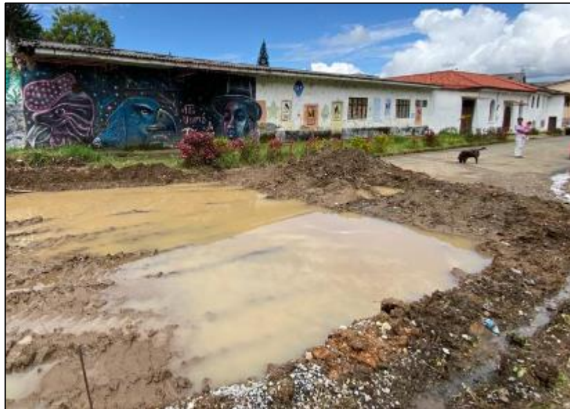
Imagen 69. Fuente propia: Falla en el tramo por lluvias
