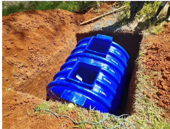
Figura 71. Tanque de agua horizontal subterráneo
