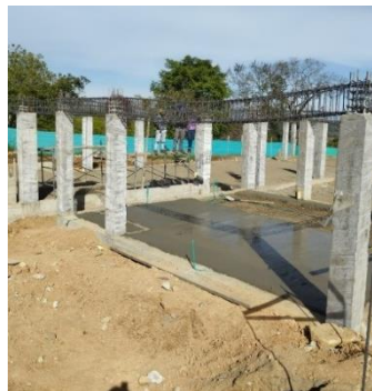
Figura 53. Nudo producido por cruce entre columnas y vigas aéreas
