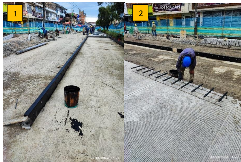
Ilustración 15. Colocación y engrase de formaleta metálica y pasadores, Foto 1: Engrase de formaleta. Foto 2: Engrase de pasadores.
