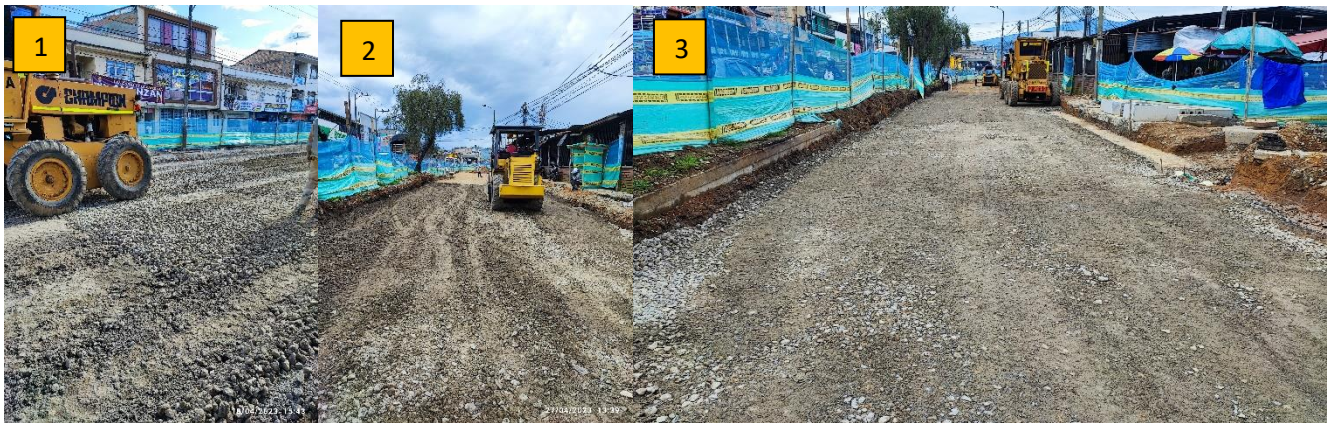
Ilustración 14. Riego y compactación de subbase granular Foto 1: cereo de subbase, Foto 2: Compactación de subbase, Foto 3: Subbase compactada.
