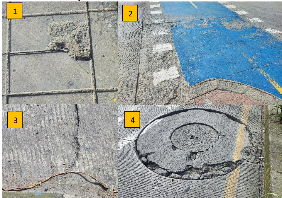
Ilustración 31. Algunas patologías encontradas en el tramo 9a, Foto 1: Loseta a reponer, Foto 2: Desintegración de la losa, Foto 3: Grieta, Foto 4: Desportillamiento de tapas.
