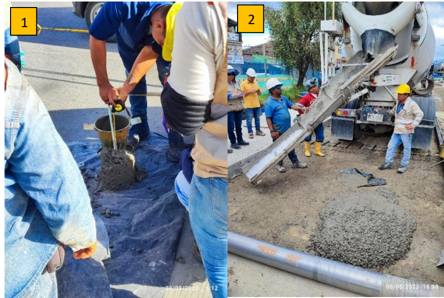
Ilustración 17. Ensayo de asentamiento y vaciado de concreto, Foto 1: Ensayo de asentamiento, Foto 2: Vaciado de concreto.
