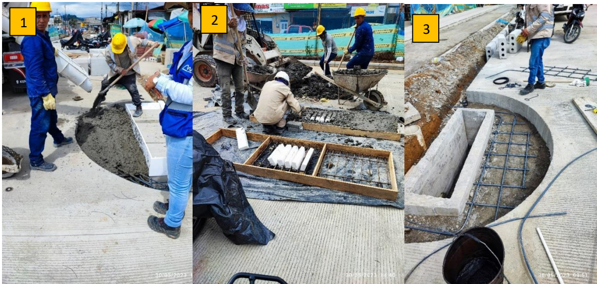
Ilustración 22. Foto 1: Fundición medialunas, Foto 2: fundición de rejillas y tapas de sumideros, Foto 3: Acero de refuerzo medialunas.
