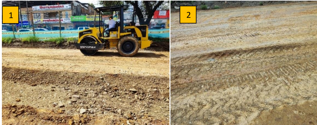
Ilustración 12. Compactación y fallo en la subrasante, Foto 1: Compactación de subrasante, Foto 2: Fallo en subrasante.
