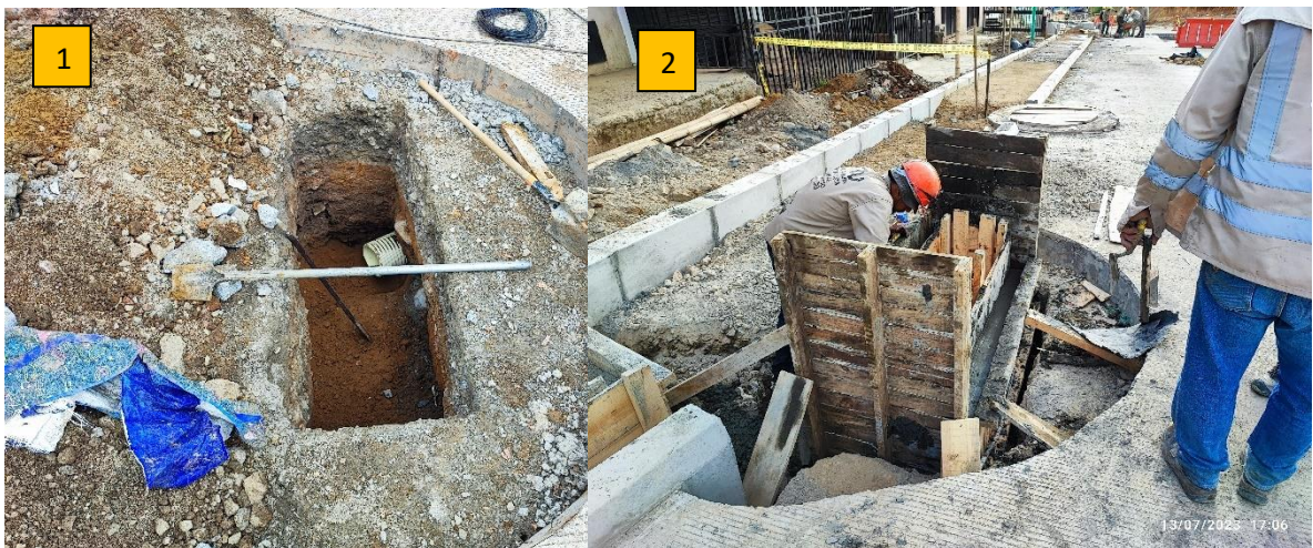
Ilustración 57. Excavación y fundición de sumideros calzada sur tramo 7B, Foto 1: Excavación manual en sumideros, Foto 2: Fundición del sumidero.
